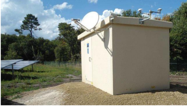
Poste de livraison
